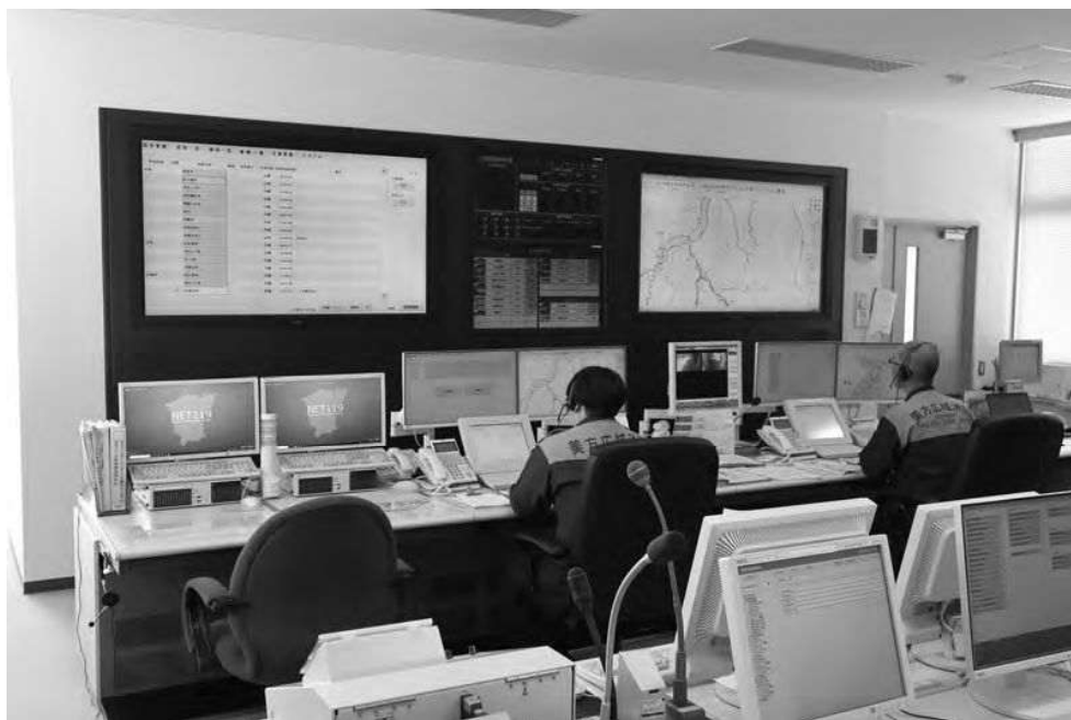
高機能消防通信指令施設
