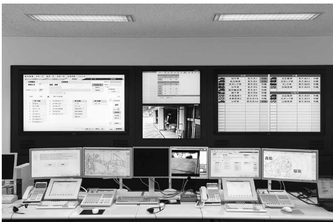
高機能消防通信指令施設
