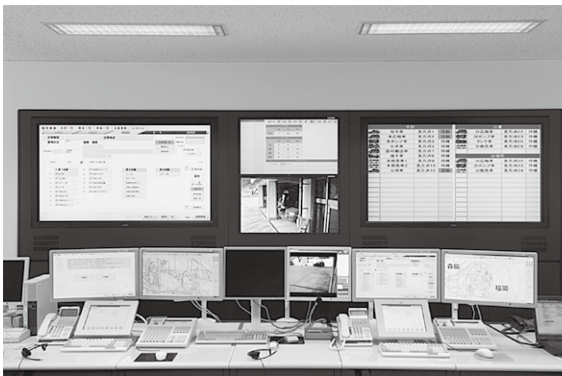
高機能消防通信指令施設
